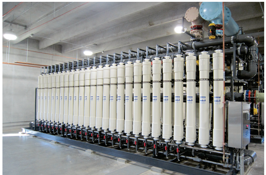
図 1: UF膜処理設備 Wigen Water Technologies社 ( www.wigen.com )より
