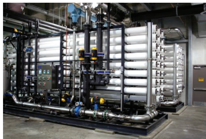
図 3 東レROを用いたRO処理設備
