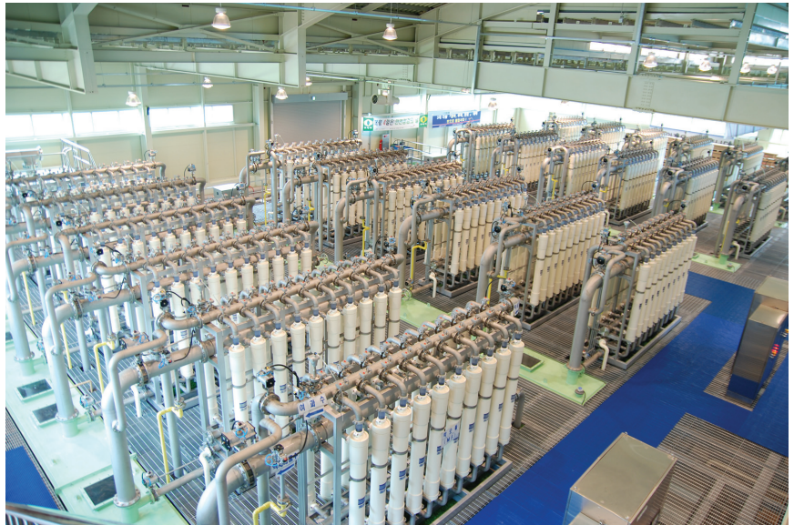
図1: 公州処理設備でのUF膜プラント
