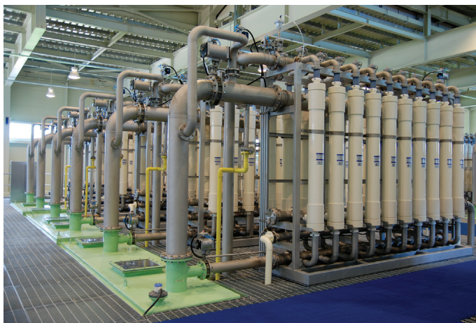
図3: 公州水処理設備でのUF膜処理設備
