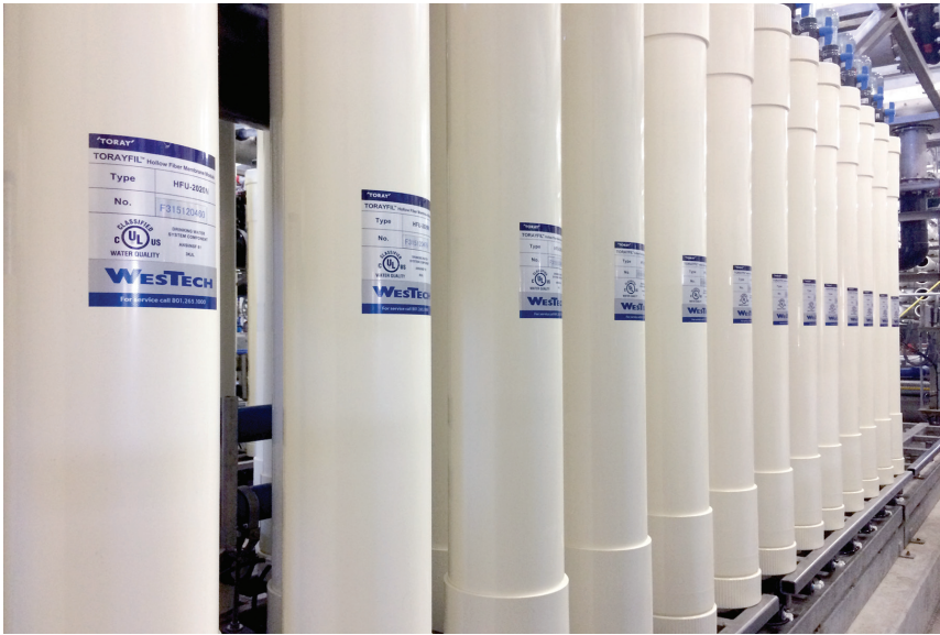
図 1: WesTech Engineering社によるUF/RO設備
