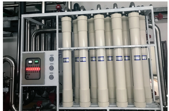
図 3: 西烏火力発電所での東レUF膜設備
