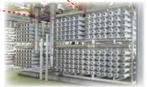
RO 膜処理プラント
